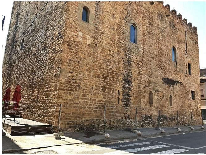
Les façanes més afectades són les que donen al carrer Cavallers i del Bisbe. ajuntament de la Bisbal
