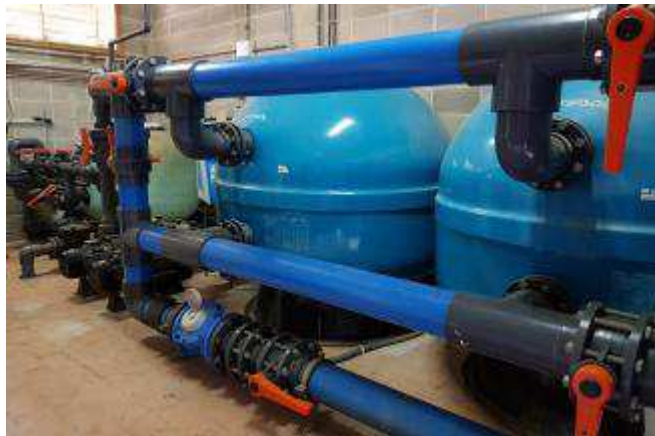
Sala de màquines de la piscina municipal Ajuntament de Sant Gregori
