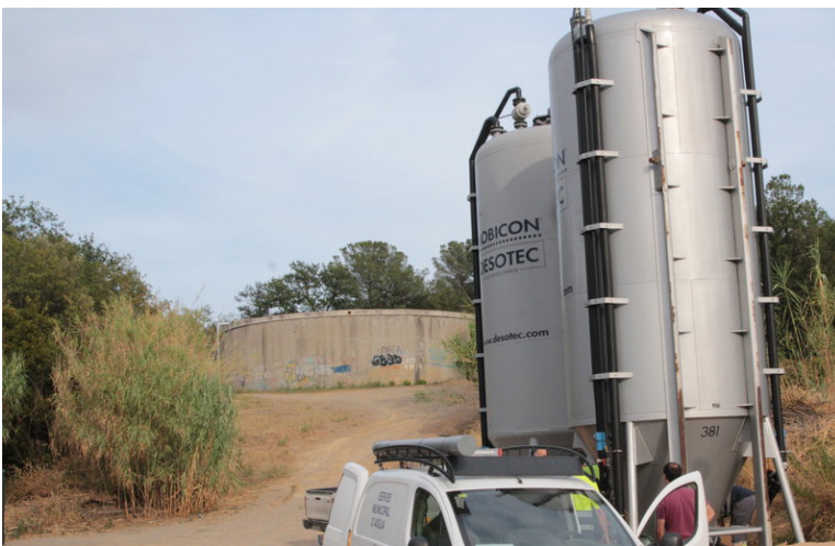
El dipòsit principal del puig de Sant Ramon, en segon terme, i el filtre instal·lat el 2016 E.A
