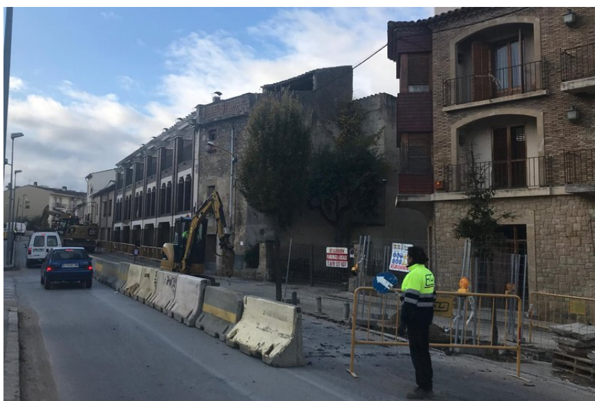
Les obres del nou col·lector que s'estan fent al carrer Germans Ferrer J.T.
