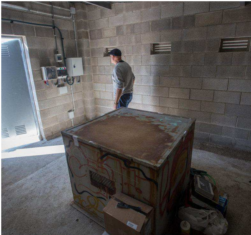
L'interior de l'edifici construït per protegir el pou de la Repsol de Caldes de Malavella. QUIM PUIG.
