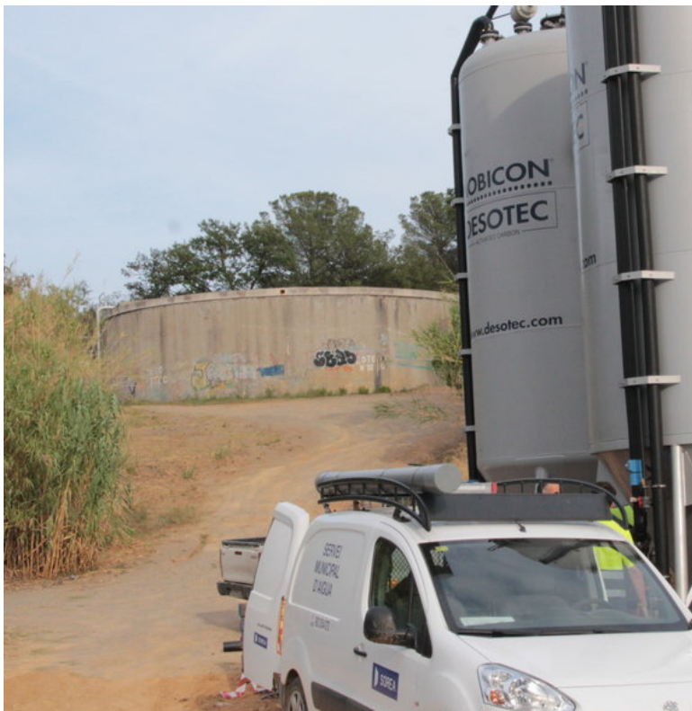
Empleats de Sorea, el 2016, instal·lant el filtre per garantir la a la Bisbal E.A.
