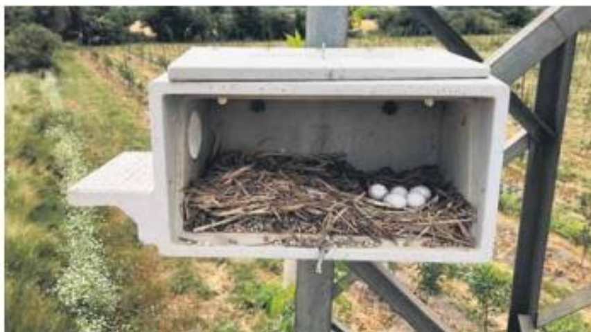
Una caixa niu en una torre elèctrica a la zona dels Aiguamolls ■ IMATGE CEDIDA ENDESA
