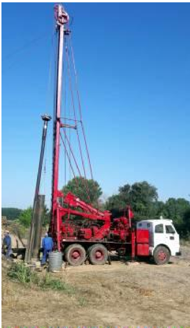
La màquina que treballa per obrir el nou pou a Fontanilles. ACN
