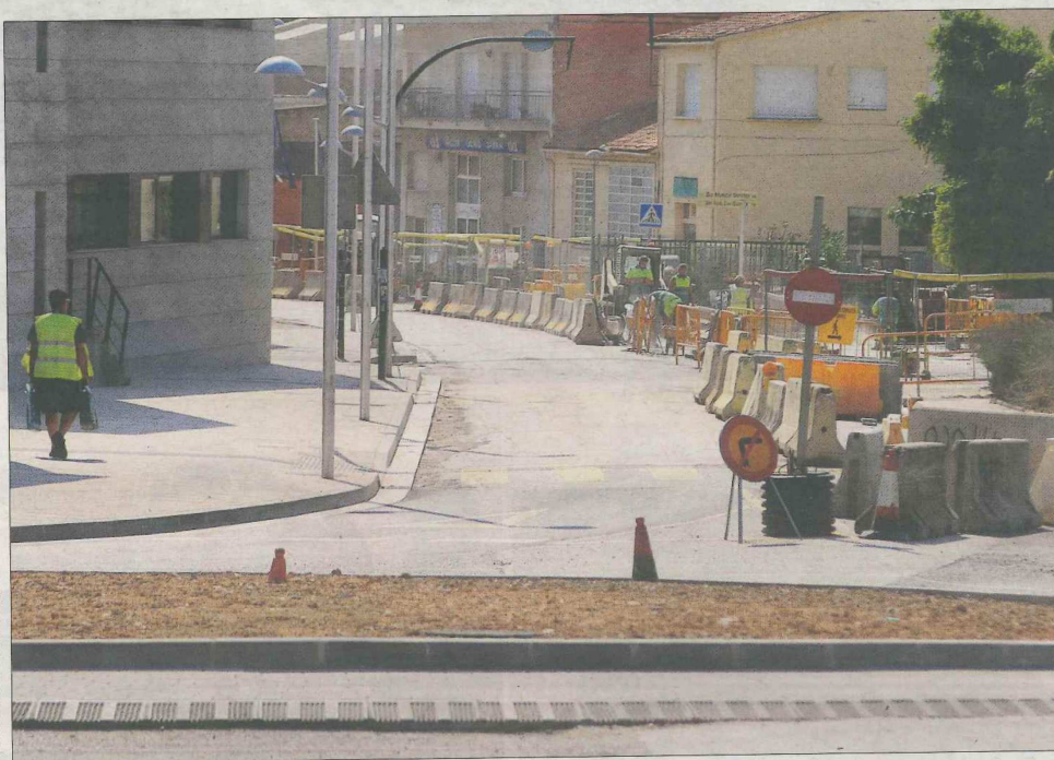
Obres a la carretera de Llagostera, que travessa tot el poble. Els treballs es van endarrerir per la troballa de restes arqueològiques ■ QUIM PUIG
