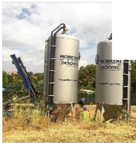
Els dos filtres instal·lats al dipòsit de subministrament d'aigua.
