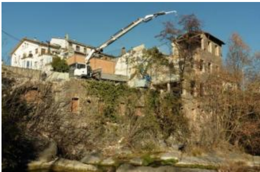
Els treballs d'enderroc de la fàbrica erigida sobre el molí de Capsarroca.
