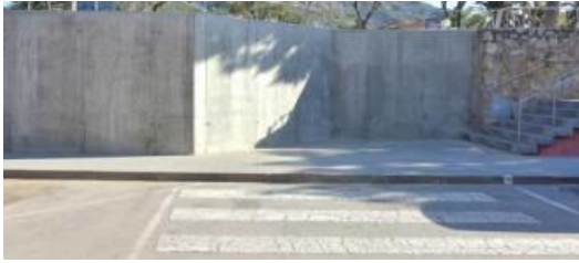
Vorera de Torroella amb desnivell entre aquesta i la calçada.
