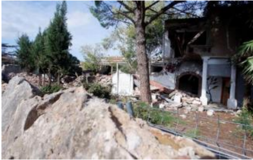
Imatge de l'interior de la finca, on ja s'ha enderrocat part de les edificacions.
