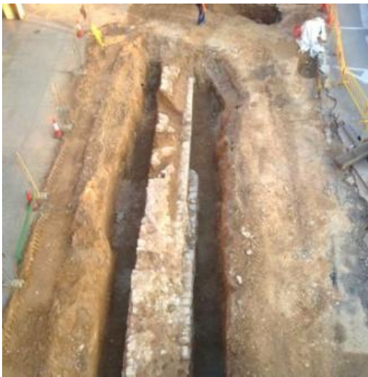
Dues imatges del tram de fonaments de muralla que es va posar al descobert arran de les obres de la plaça del Lledoner.
