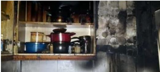
L'incendi en un pis d'un edifici de set plantes.
