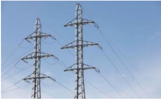
Una línia elèctrica a les comarques de Girona.
