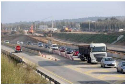
Obres de desdoblament de l'N-II en el tram Sils-Maçanet, a l'altura de Vidreres, el passat febrer.
