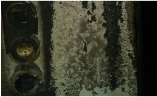
Les flames han afectat la instal·lació elèctrica
