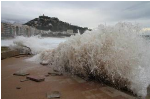
El mur va quedar parcialment ensorrat a causa de les fortes onades del temporal del desembre.
