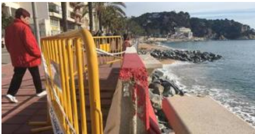
El mur afectat al passeig marítim
