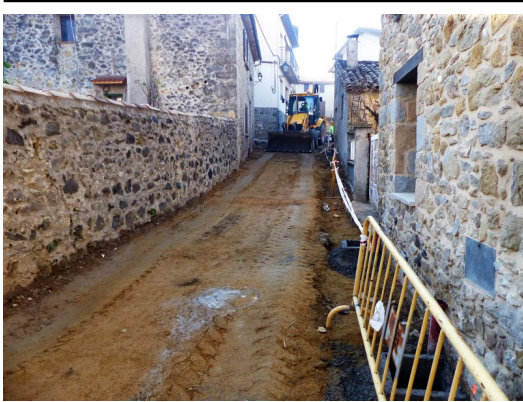
Un detall de les obres d'urbanització del carrer d'Olot, que s'estan executant aquest dies Foto: J.C.
