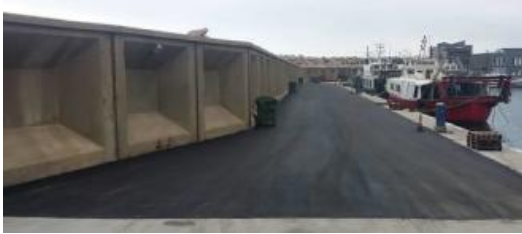
Ports acaba les obres d'adequació del moll pesquer del port de Llançà
