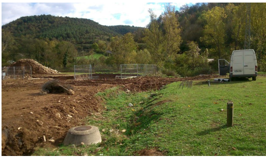
A Oix construeixen una depuradora però no podrà funcionar a curt termini Foto: Arxiu.
