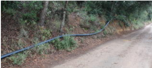
Un dels tubs de la xarxa provisional d'aigua de Vilademuls que passa per un bosc
