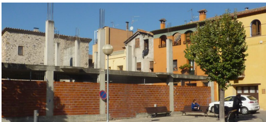
L'edifici a mig construir de la plaça de la Generalitat, que passarà a ser propietat municipal. Foto: R. E.
