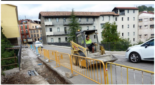
Les obres per engrandir les voreres del pont del Palau, ahir al matí. Foto: R. E.
