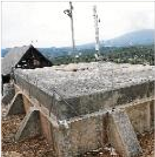
L'actual dipòsit de la urbanització.
