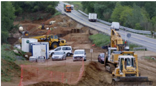
Obres de desdoblament de la N-II entre Medinyà i Oriols el maig passat.
