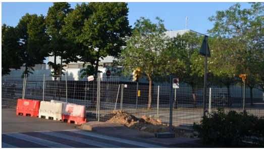
Obres davant del CAP Alfons Moré de Salt Foto: EL PUNT AVUI.
