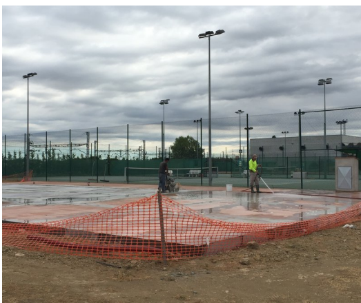
La pista de pàdel que s'està construint, al costat de les pistes de tennis Foto: J.N.
