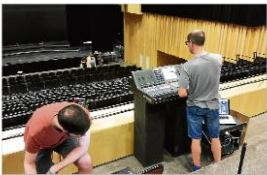
El nou equipament de sonorització de l'Auditori Teatre Espai Ter.
