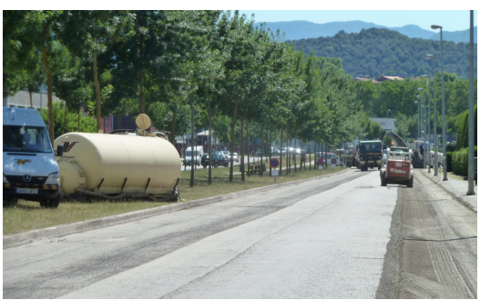
Una vista dels treballs de l'avinguda d'Europa que es van iniciar ahir al matí. Foto: J.C.
