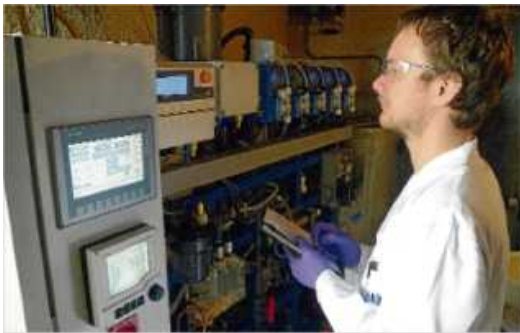
Un tècnic revisa la planta d'electrodesnitrificació que funciona de manera pilot a la urbanització de Caldes.
