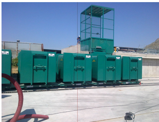
El recinte interior de la nova planta de transferència de Torroella Foto: EL PUNT AVUI.
