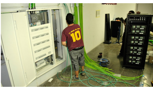
El pas del cablat de les noves instal·lacions permanents de llum i àudio de l'Espai Ter Foto: EPA.
