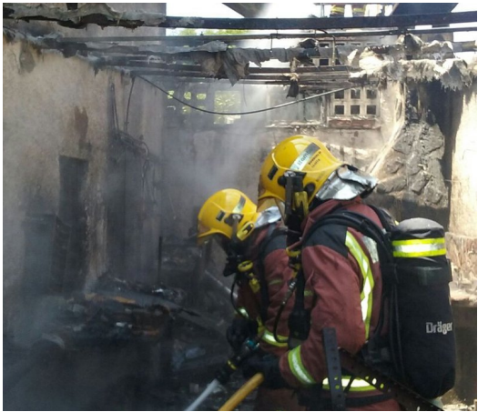
Va resultar afectada la part del porxo i la terrassa de l'habitatge. Foto: BOMBERS.
