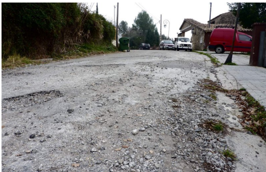
La calçada, malmesa, d'un carrer de la reurbanització de Puig Surís. Foto: R. E.
