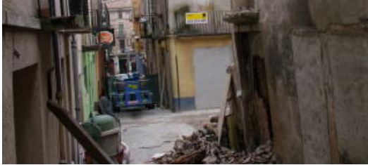
L'edifici està essent enderrocat després d'esfondrar-se el teulat
