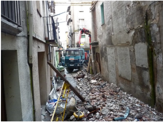
Aspecte del carrer Lliberada Ferrarons i els treballs d'enderroc de l'edifici en ruïnes, ahir al vespre. Foto: R. E.
