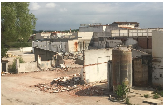
Aspecte actual de les instal·lacions de Frigorífics del Ter de Salt, situades a tocar l'autopista Foto: J.N.
