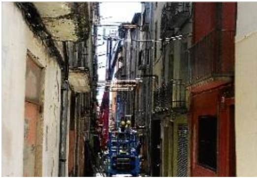
Avança l'ensorrament d'una casa a Olot
