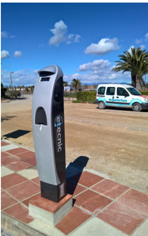
L'estació de càrrega del càmping Aquàrius
