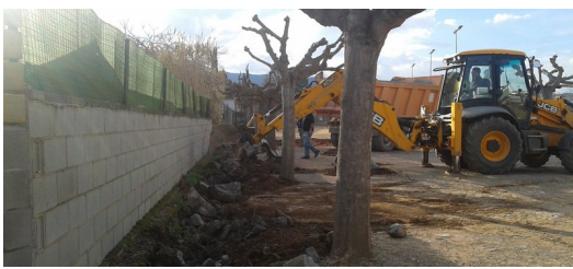
Una màquina treballant aquesta setmana en les obres del pati de l'escola L'Entorn. Foto: AJUNTAMENT DE PORQUERES.
