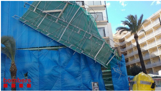
L'estructura que va caure estava muntada a l'hotel Gran Flamingo. Foto: G. P. / BOMBERS.
