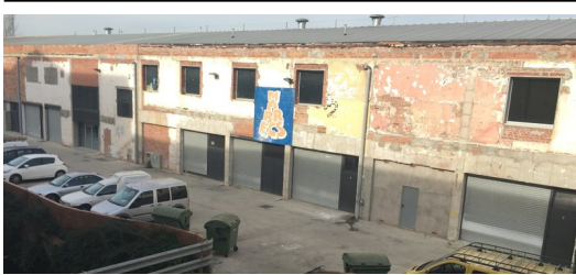
Algunes de les façanes de les naus Guixeres, que estan molt degradades i que els comptes per al 2016 contemplen una partida per rehabilitar-les Foto: J.N.
