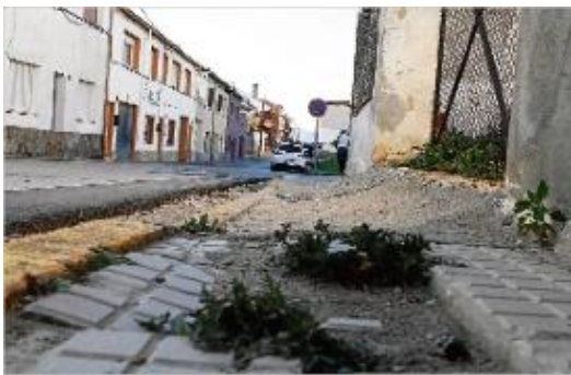
Les voreres actuals presenten alguns desperfectes.
