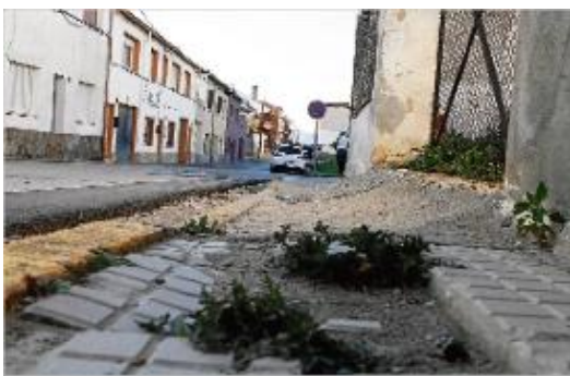
Les voreres actuals presenten alguns desperfectes.
