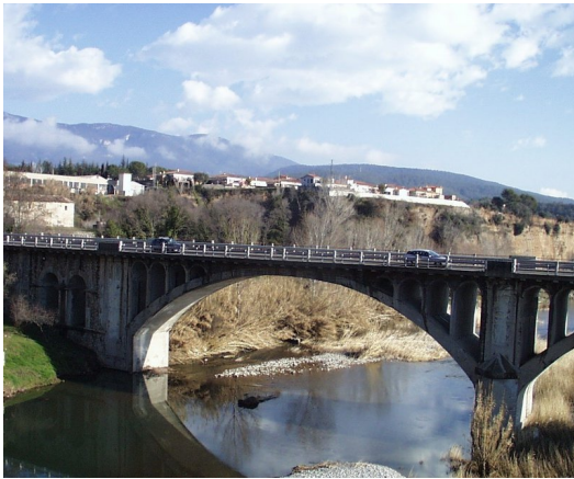
El pont afectat.
