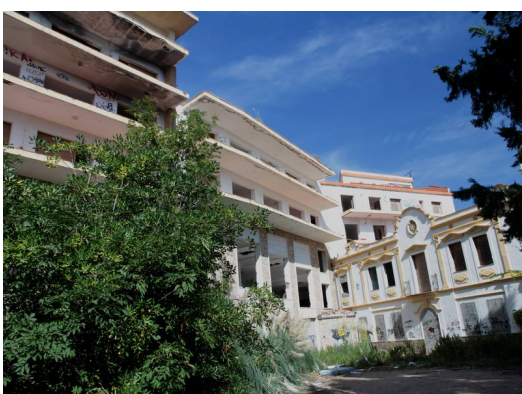
El complex de l'hotel Panorama, abandonat des de 2003 i molt deteriorat pel saqueig furtiu i les bretolades a les dependències Foto: E.A.
