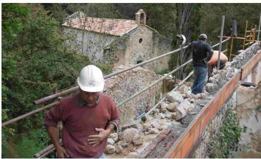
Treballs a la coberta d'un dels edificis de l'antiga rectoria, quan es trobaven en la fase inicial. Foto: JOSEP VILAR.
